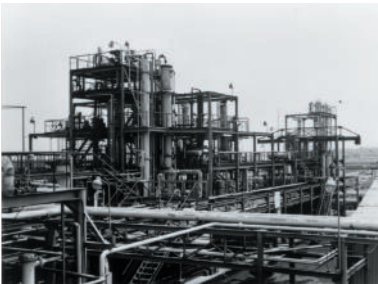
④ 千葉工場のフロンプラント
